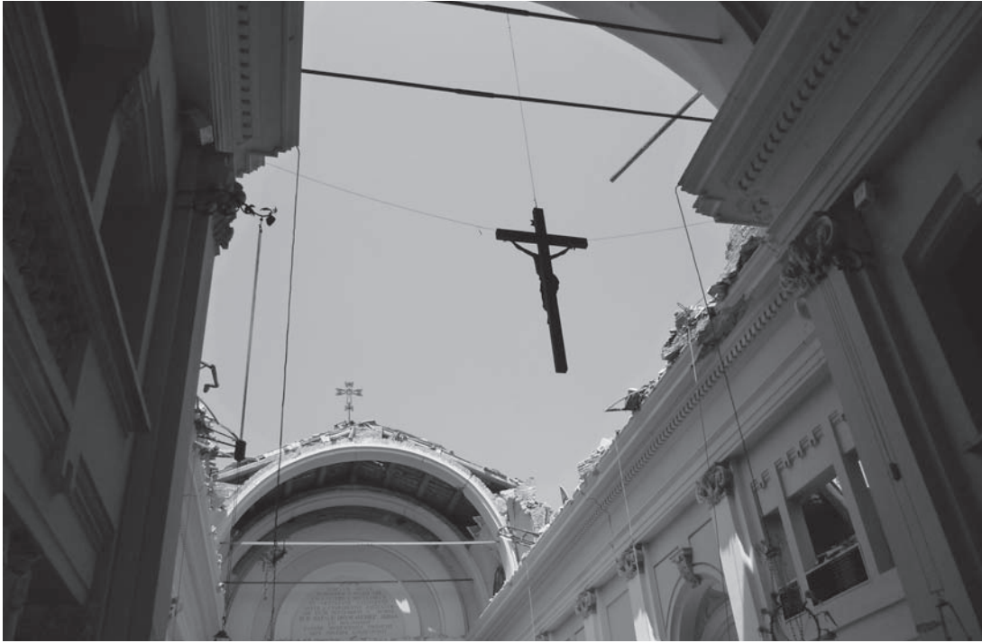
1. Cavezzo, chiesa parrocchiale di S. Egidio abate. Veduta della navata dopo il crollo della copertura e delle volte.
